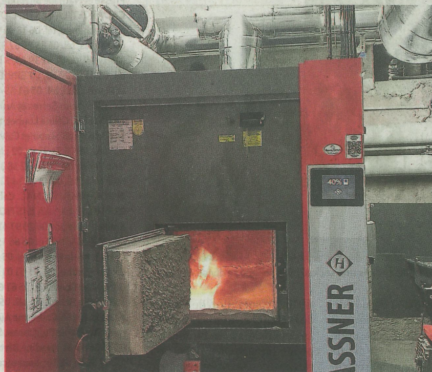
La chaufferie biomasse réchauffe 200 locataires à la cité Pierre-Faur./MHD
